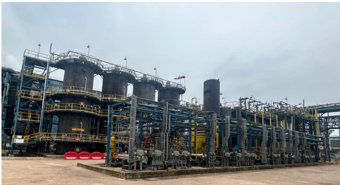
Image 1 : Système d'extraction de gaz de cokerie et d'hydrogène de PyroGenèse chez Tata Steel, à Kalinganagar, en Inde
