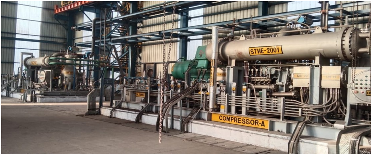
Image 2 : Unités de compresseurs à injection d'eau en service chez Tata Steel, Kalinganagar, Inde
