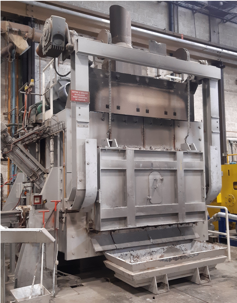
Image 1 : four de fusion à réverbère utilisé dans l'une des installations de Constellium pour l'aluminium.
