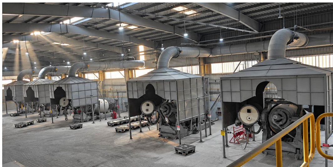
Image 2 : Les systèmes Drosrite MC de PyroGenesis prêts à être utilisés dans les installations de Radian Oil & Gas Services en Arabie saoudite.
